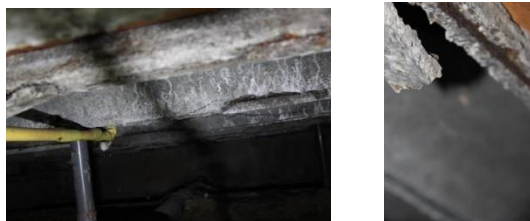
Schade aan kwaaitaalvloer
