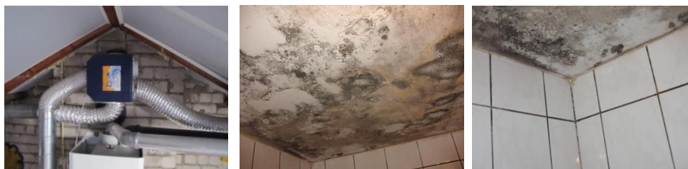
schimmelvorming op plafond badkamer, vooral badkamers moeten een goede ventilatie hebben
