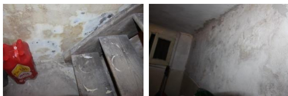
vochtsporen op kelderwanden, vaak gebrek aan ventilatie, regelmatig ook lekkende kelders
