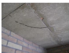
Asbest plafond garage
